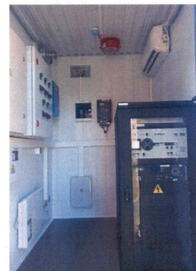
Оборудование внутри контейнера
